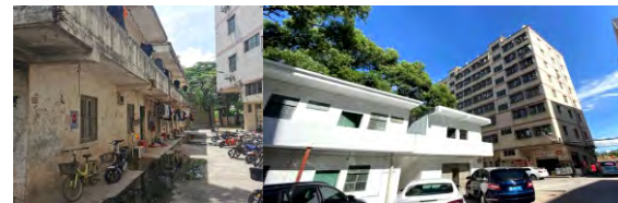
左：房源改造前，因排水不畅，租客门前污水横流。右：升级改造后的房源外景。
